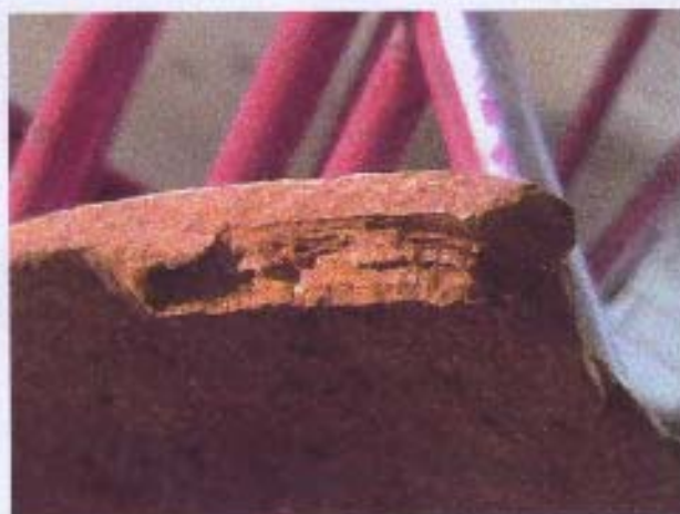
Soudure rompue en extrémité du plat Rupture « récente ».
