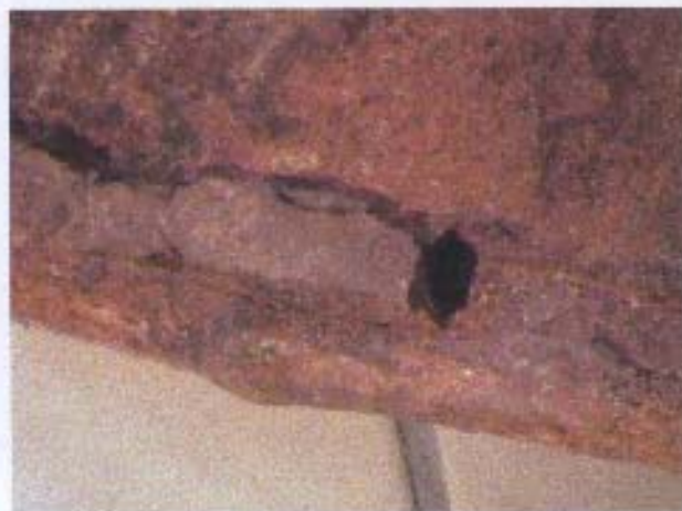
Fissure pied de cordon.
