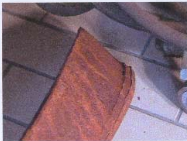
Cordons desoudure rompus : liaison entre ailes.
